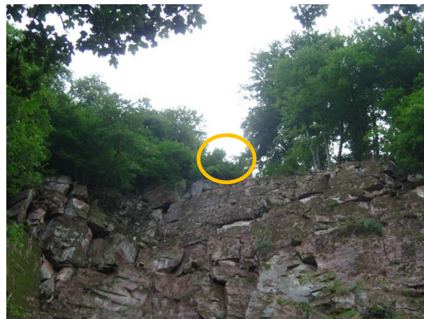
Die Büsche am oberen Rand des Steinbruchs (gelber Ring) müssten entfernt werden.
